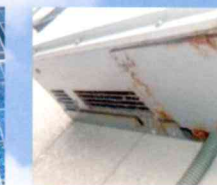
さび・腐食等の 経年劣化
