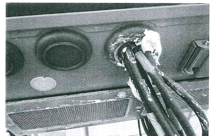
写真3 配線連結部不良
